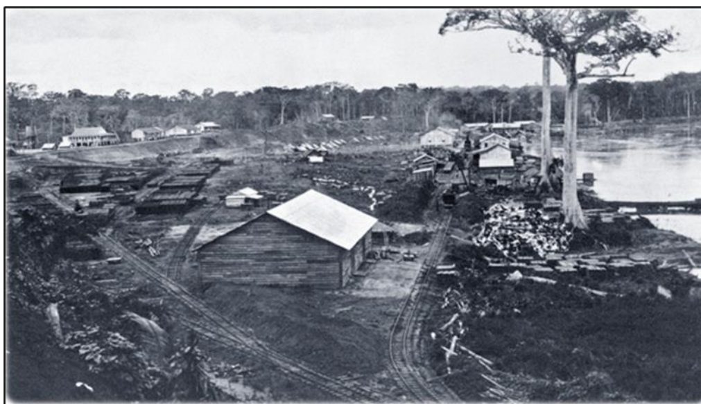
Canteiro de obras de Porto Velho, em 1909, margem direita do Rio Madeira, durante a construção da Ferrovia.
